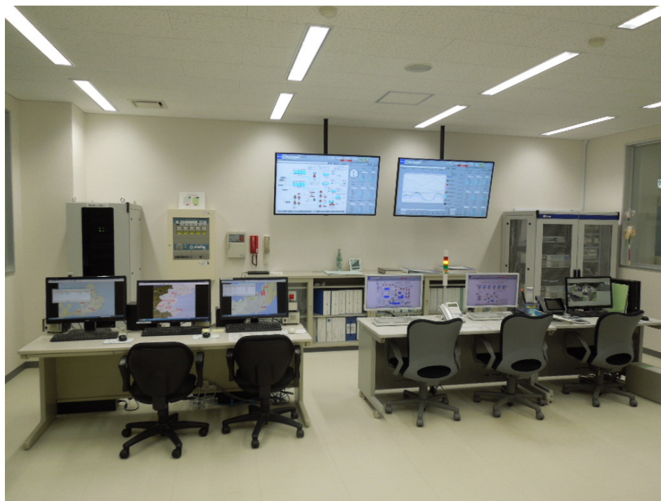
自動化が進んだ平田浄水場の管理室
