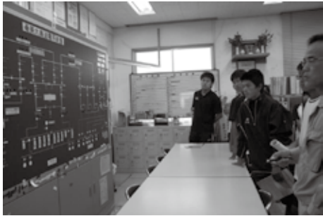
【九州電力龍郷発電所 2】
