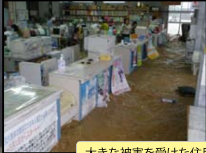
大きな被害を受けた住用 総合支所1階フロア
