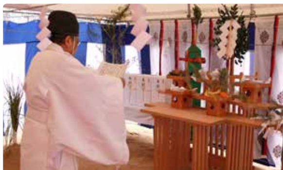
▲生涯学習の拠点となる「市民交流センター」の新築工事安全祈願祭が建設地(名瀬柳町・旧水道課跡地)で行われました。2021年5月下旬の完成をめざしています。(4月13日)
