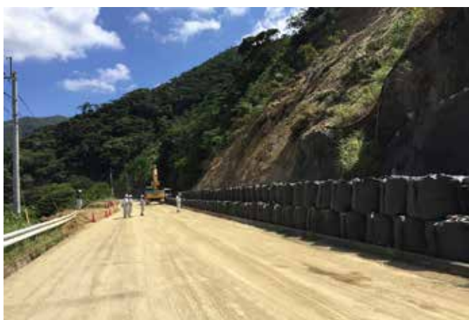
片側通行可能となった山間・市線 (8月14日現在)
