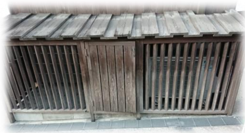
▲建物と調和した室外機の設置事例（倉敷市）
