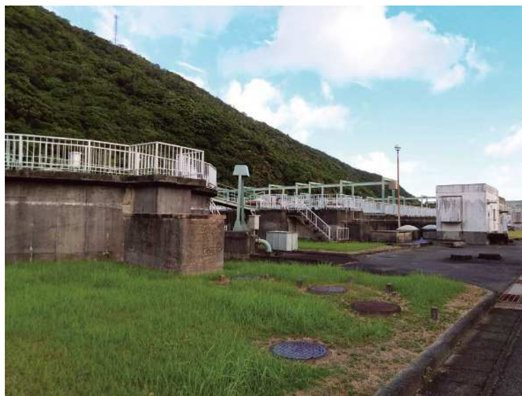
浄化センター（名瀬終末処理場）
